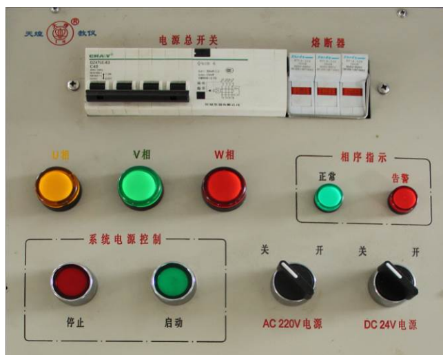
图1 平台电气控制面板1（局部）
