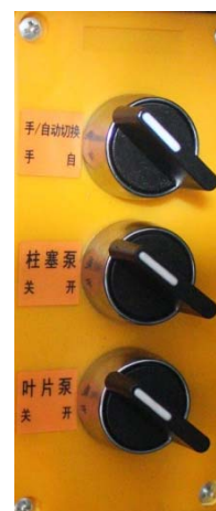
图3 泵站控制电控盒
